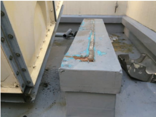
地震により架台から落下した高置水槽 ※
