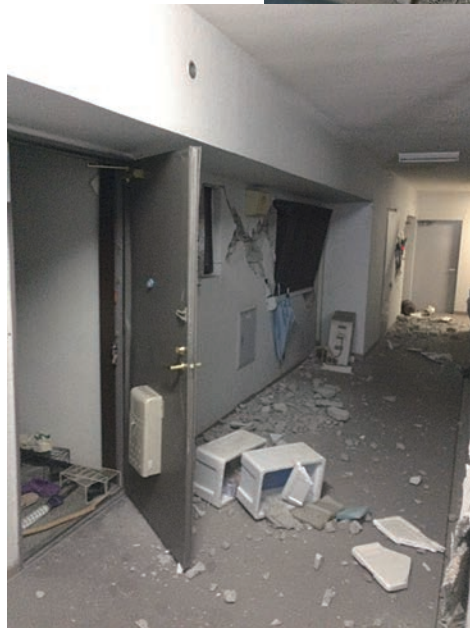
本震後 共用廊下側被害状況 ※
