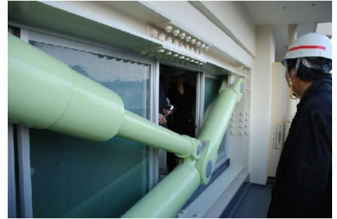
バルコニー側の制震ブレース
