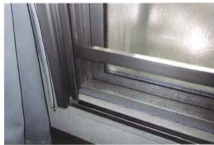
図12 サッシ更新後のアルミ面の結露
