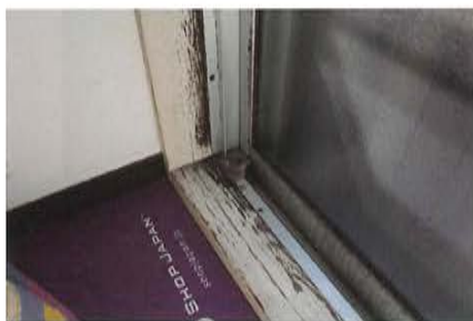
図10 工事前 窓廻りの結露・黒カビ
