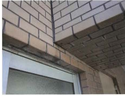
図 14 工事前 まぐさ・梁下端の白華現象
