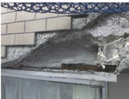
図 20 まぐさ廻りの躯体不良部
