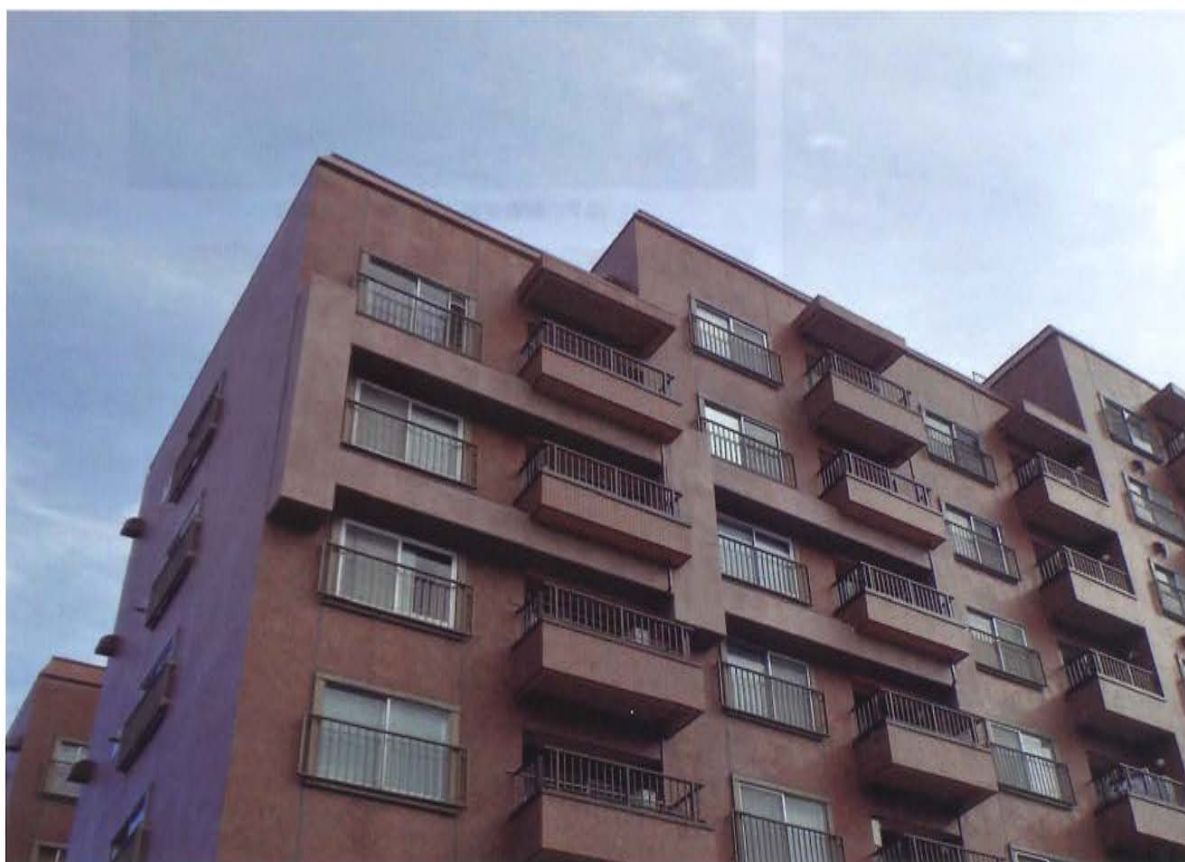
図11 中間階のバルコニー面に設置された柱外付けフレーム
