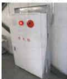
写真D 屋内消火栓箱
