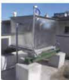
写真B 消火用補助水槽
