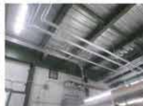
写真C 配管・電気ラック
