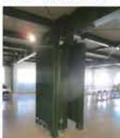
写真E 除湿型放射冷暖房機
