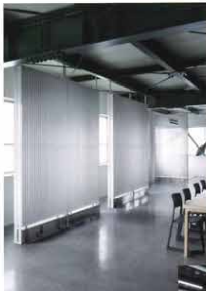
ショールーム空調システム
