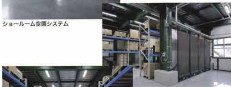
1階空調システム
