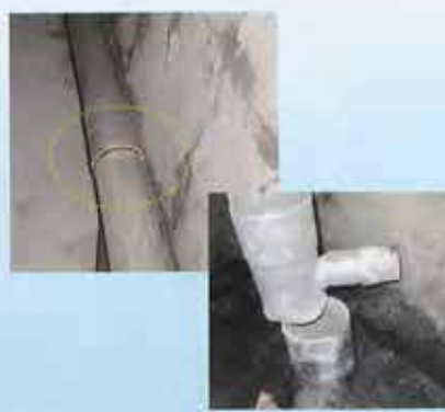
築50年経てば塩ビ管だって割れる 排水管の漏水はこれでもなかなか気づかない
