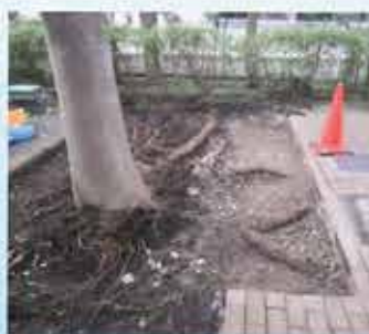
舗装を押し上げてしまった根。(舗装を除去したところ)
