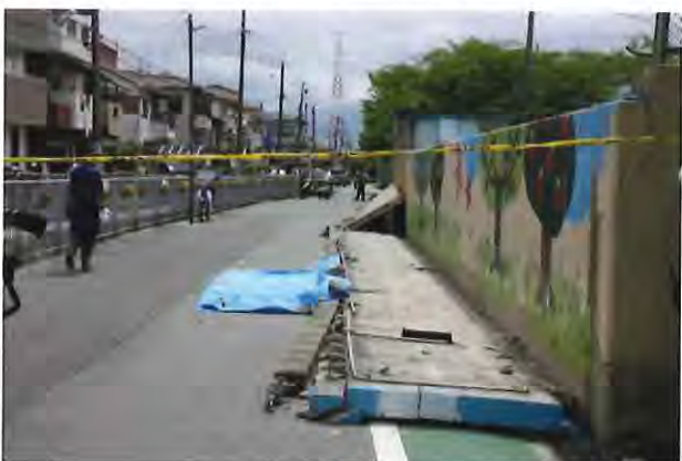
写真5 地震後の状況
