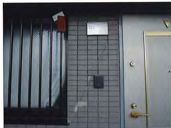
写真2・3 非構造壁の被害
