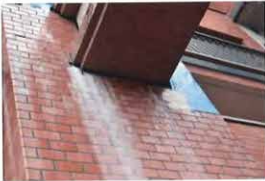
写真7 被災後1年目の写真 構造の被害は軽微でも、時間の経過とともに劣化し美観が損なわれれば、復旧意欲は下がる。
