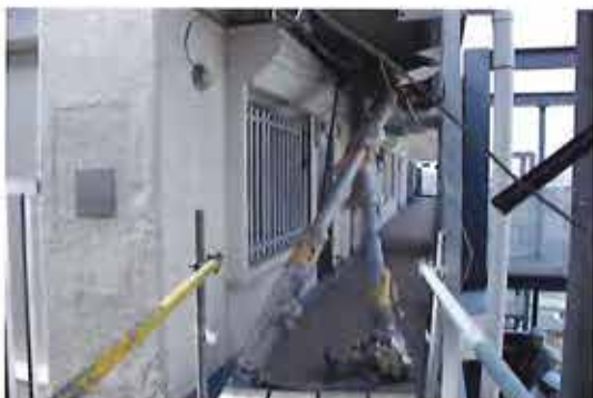
写真5 エキスパンションジョイントを渡る給水横主管の破損
