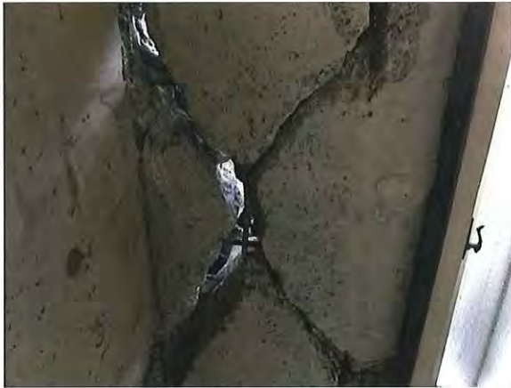
専有部分内側からみた雑壁せん断破壊
