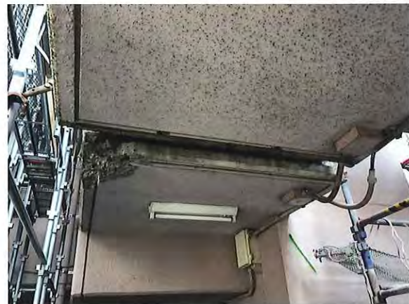
棟と棟の変位は復旧しない
